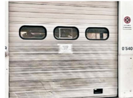
Due basculanti dei box per le ambulanze sono di nuovo guasti
